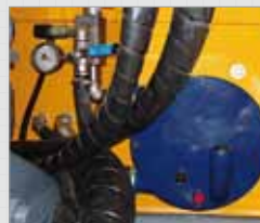
2 Bomba de aditivos
